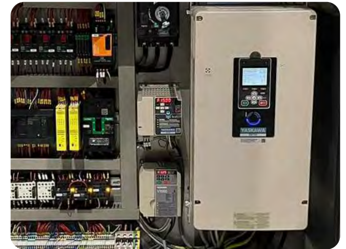
Arranque y parada suave de cuchillas, artesa y disco descargador mediante variadores electrónicos.
